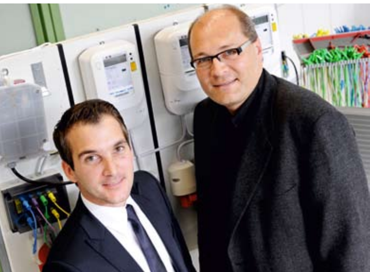
Christian Rehtanz, TU Dortmund (rechts), und Björn de Wever, Leiter der Abteilung Forschung und Entwicklung der EVB Energie AG, arbeiten gemeinsam daran, den Weg für einen flächendeckenden Einsatz von Smart-Meter-Systemen zu ebnen.
